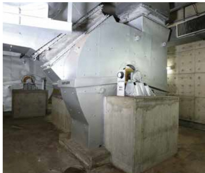
誘引送風機 燃焼を安定的に行うため焼却炉内の圧力を負圧に維持するための設備です。排ガスを煙突まで送風しています。
