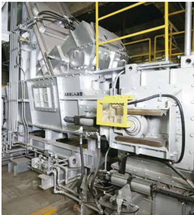
給じん装置 二軸スクリーンで構成され、ごみを連続して定量的に直接焼却炉に供給します。
