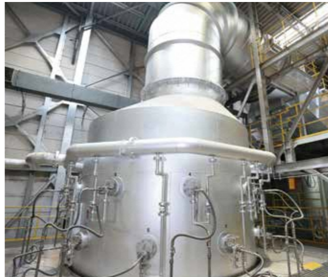
ガス冷却室 焼却炉の高温の排ガスを冷却水噴霧によって冷却する設備です。冷却水は工場内から発生する汚水を薬剤処理したうえで再利用しています。
