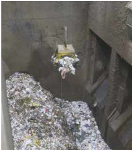
ごみピット 収集されたごみを貯留し、攪拌、均一化する設備です。
