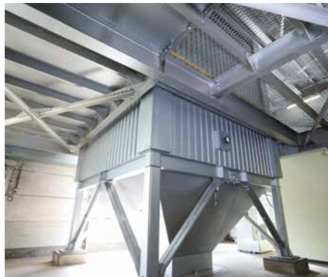
触媒脱硝塔 集じん装置を通過した排ガスをさらに処理する設備です。蜂の巣状の触媒が3層に設置されており、この触媒を通過させることでダイオキシン類や窒素酸化物の分解除去が可能となっています。
