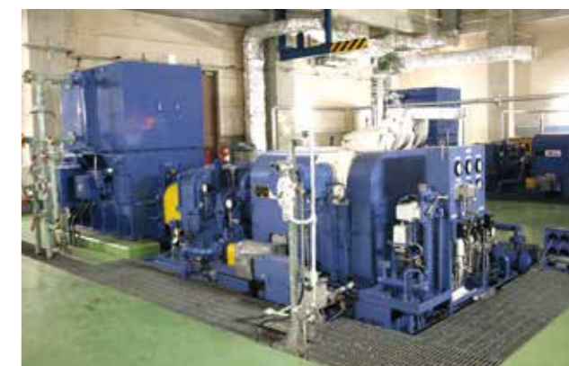
蒸気タービン発電機
