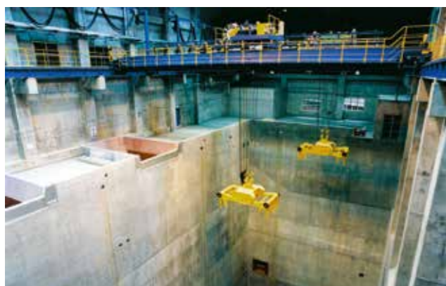
ごみピット/ごみクレーン
