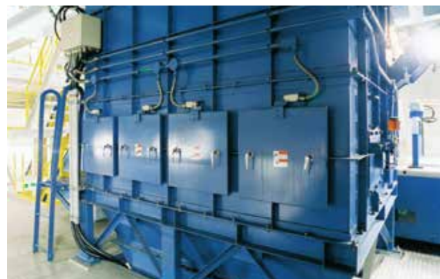
破袋除袋機 ごみ袋を取り除き、中から資源ごみを取り出します。
