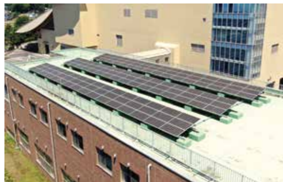
太陽光発電（管理棟上）
