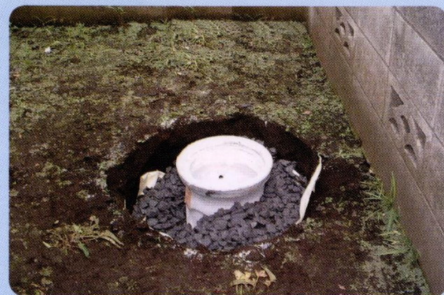
3. 雨水浸透マス
