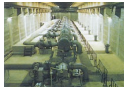
⑥送水ポンプ このポンプで、所沢市などの市町村へ水道水を送り出す。
