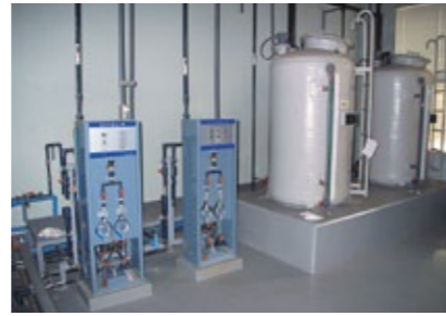
③消毒設備 消毒剤(次亜塩素酸ナトリウム)で消毒・滅菌するための設備。
