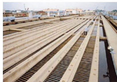
②薬品沈でん池 薬品を混ぜて、水の中のゴミや砂を沈める。
