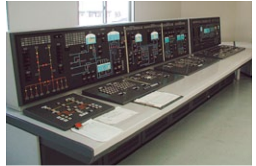
監視室の様子
