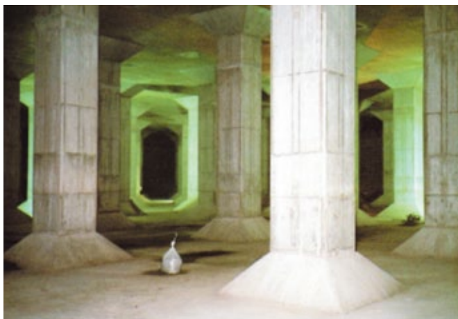
雨水調整池の中の様子
