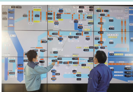
監視制御盤で水の流れを監視しています
