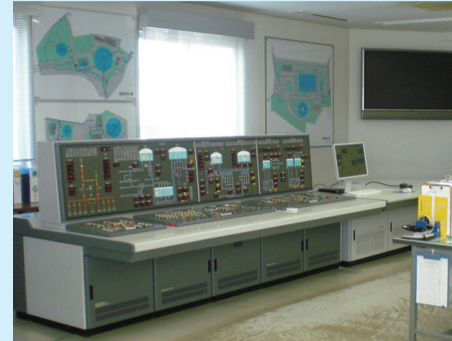
▲各浄水場の運転を遠隔で監視
