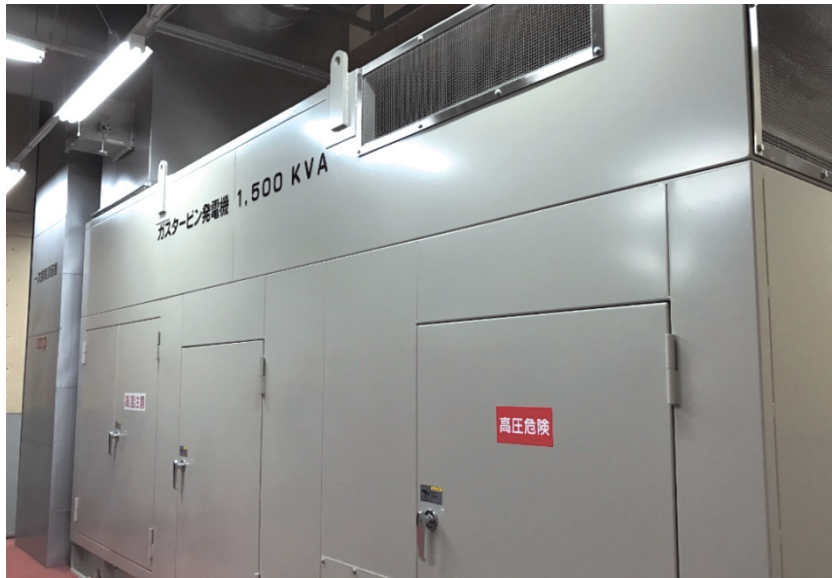
非常用発電設備
