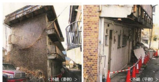
外壁、手すりが崩落した事例
