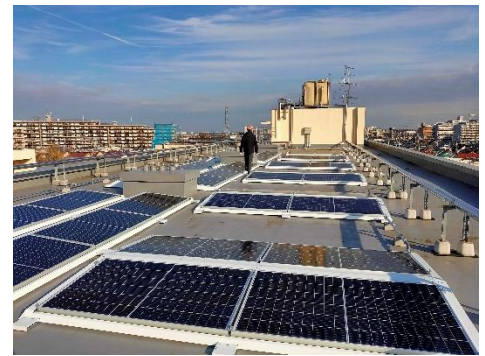
■太陽光パネル（向陽中学校屋上）
