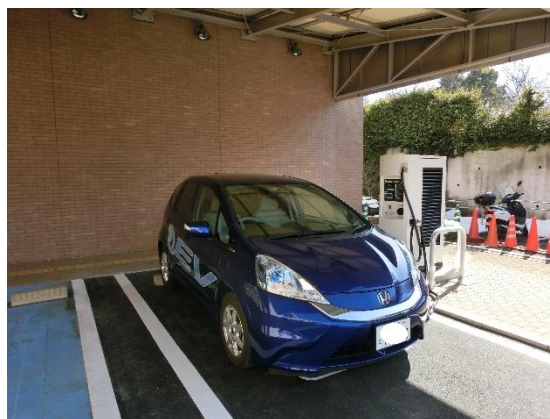
東部クリーンセンターEV急速充電器
