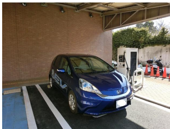
東部クリーンセンターEV急速充電器
