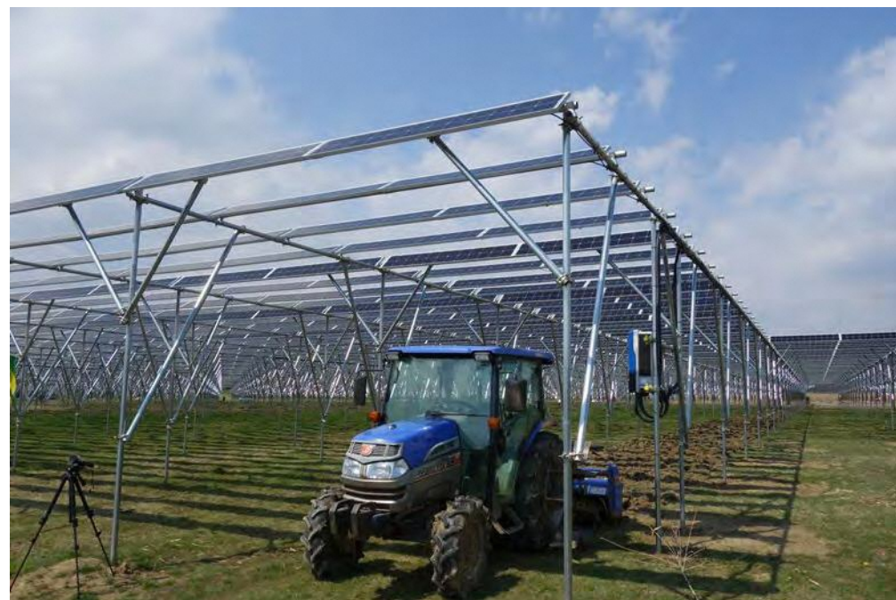
市民エネルギーちば(株) 千葉県匝瑳市 匝瑳メガソーラーシェアリング第1発電所
