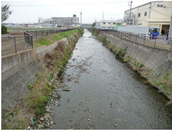
河床には礫や土砂が堆積している
