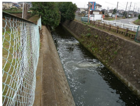
還流水が供給されている
