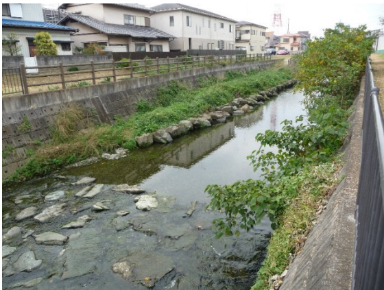
河床には礫や土砂が堆積している
