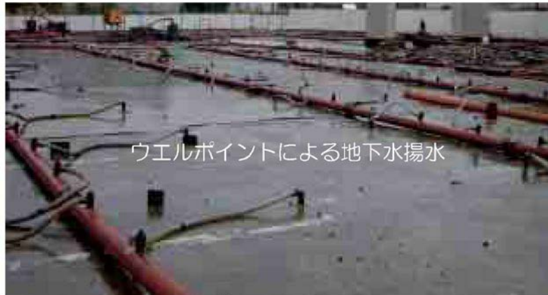
図 8-12 地下水揚水の概況写真
