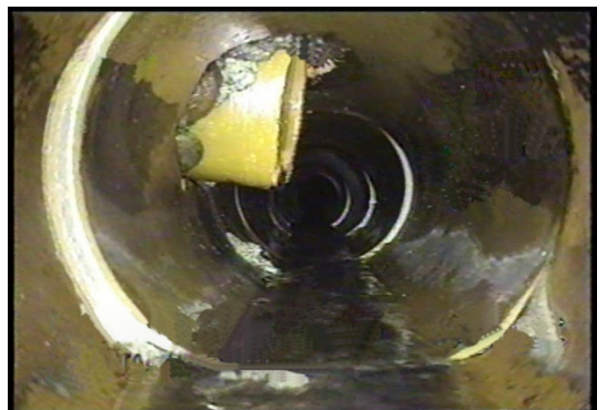
取付管が突出し老朽化した管渠(参考)
