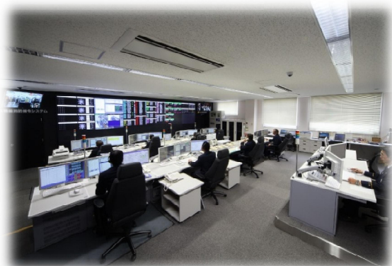
通信指令センター
