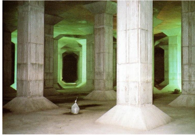
緑町中央公園調整池（地下式）
