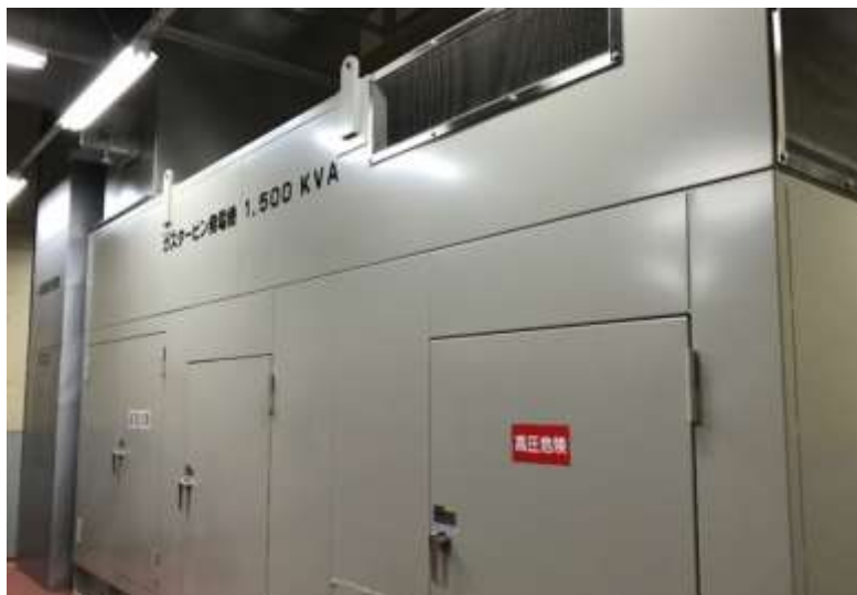
非常用発電設備
