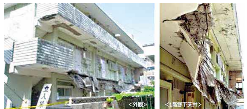
▲マンション2階の廊下が崩落している
