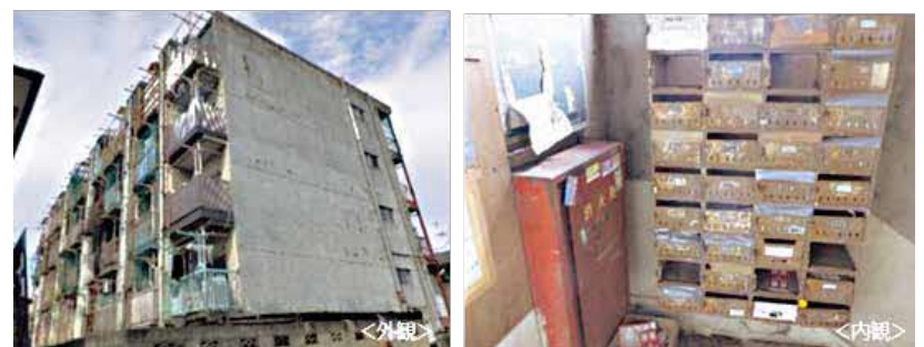
▲建物の痛みが著しく、鉄骨の露出、外壁がはがれている
