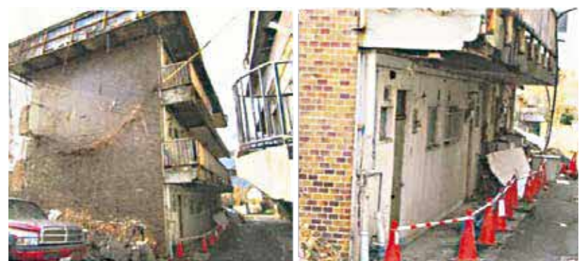
▲外壁と手すりが崩落している
