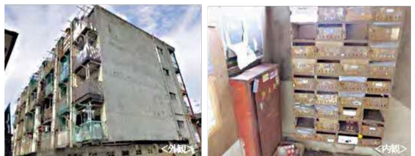
▲建物の痛みが著しく、鉄骨の露出、外壁がはがれている
