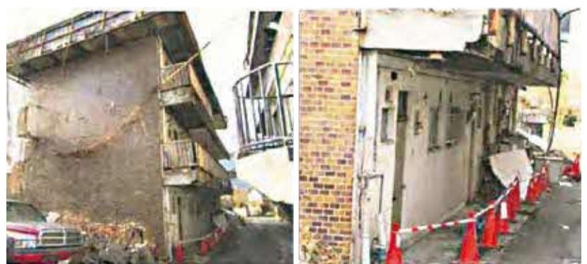
▲外壁と手すりが崩落している
